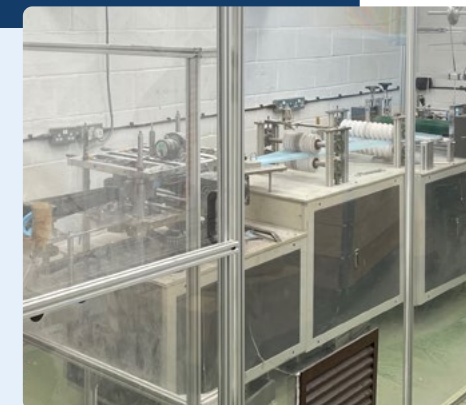
Nuestras instalaciones de producción de salas blancas
